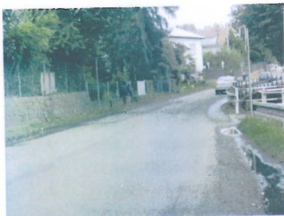
Obr. A3 – Chybějící chodník podél silnice III/4867
