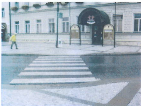
Obr. A1 – Přejchod pro chodce před MěÚ budovou 1, chybí varovné a signální pásy
