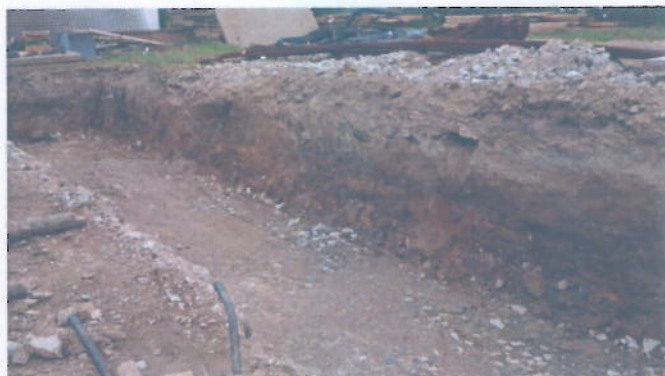
Obr. 2 Průběh zakládacích prací v jv. části staveniště - místo drobných rozptýlených vývěrů mělké podzemní vody na dně výkopu (02.06. 2015)
