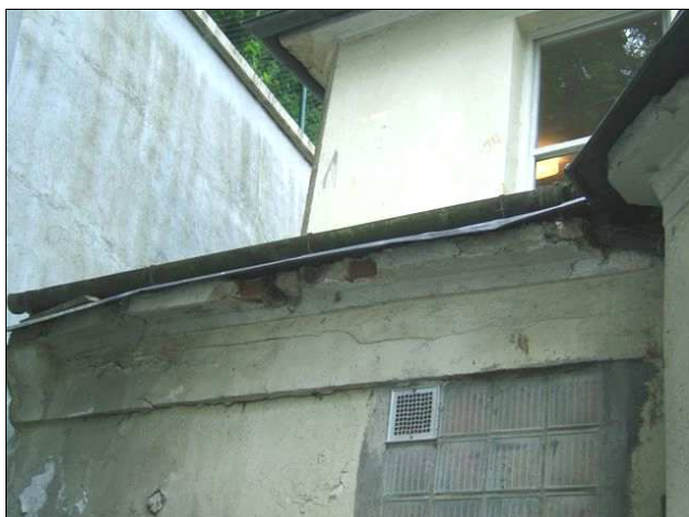
Foto /31/ Střecha 7 – Pohled na okraj střechy pod okapní hranou (v administrativní sekci budovy)
