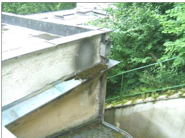
Foto /22/ Střecha 5b – Odvodnění zaatikového žlabu střechy vnějším svislým dešťovým svodem
