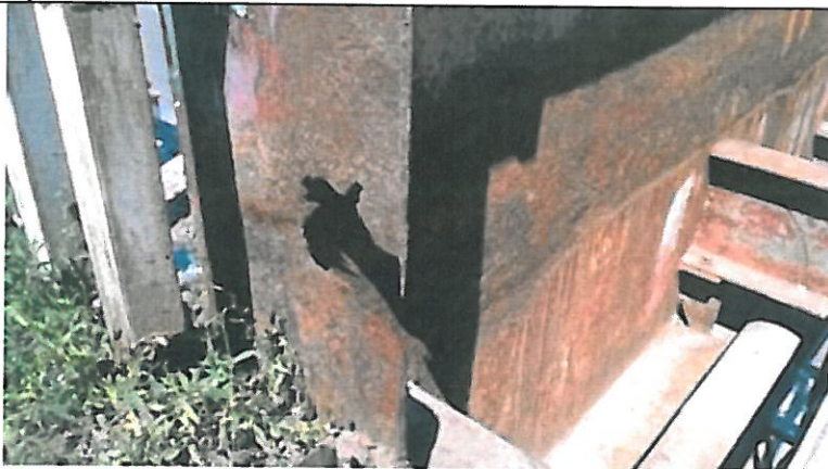
Degradace koroze mostní ocelové konstrukce. Provádí se výměny a opravy prvků a to dle dispozic statika.
