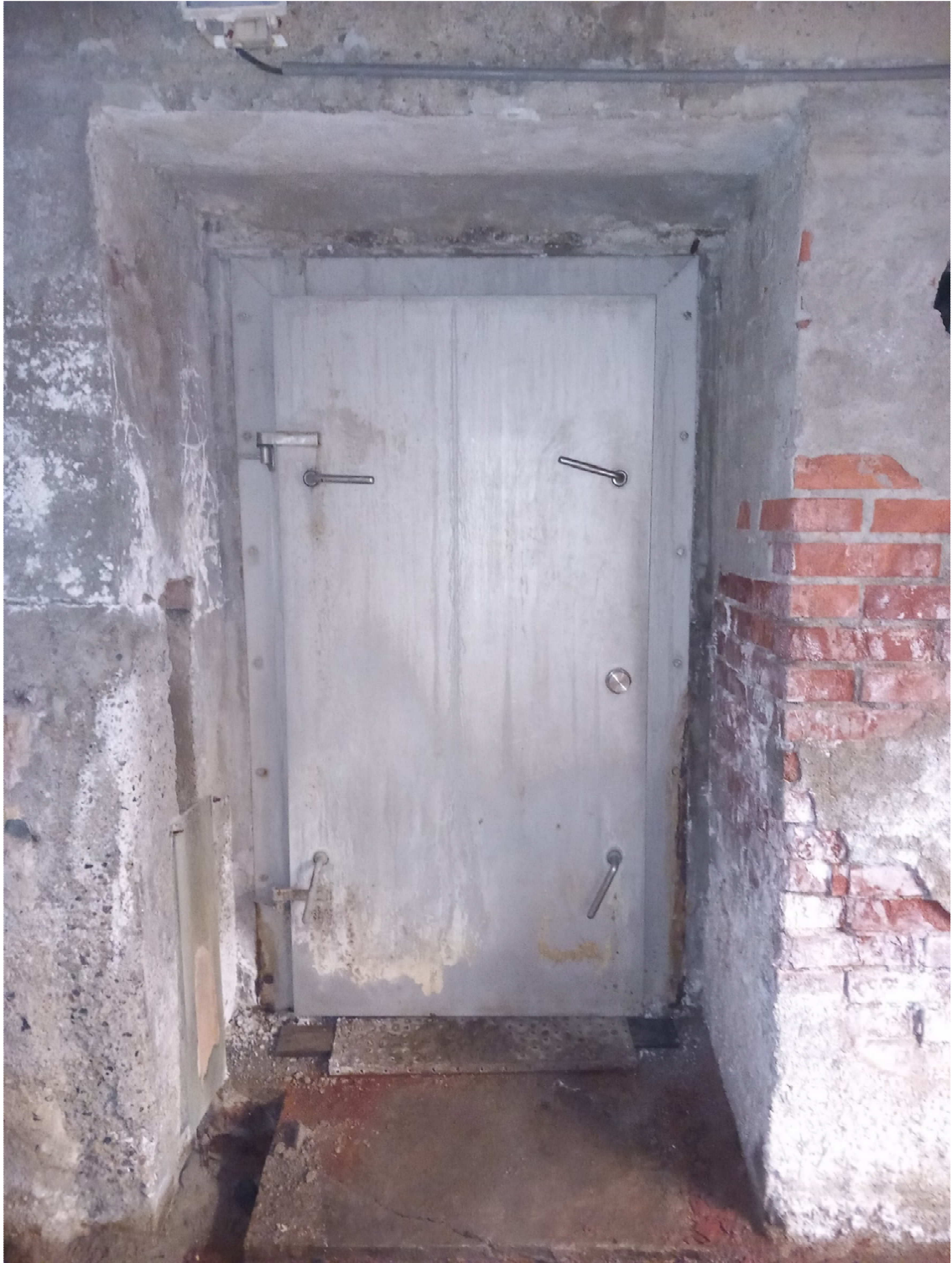
Protipovodňové dveře vstupu do 1.PP kolonády
