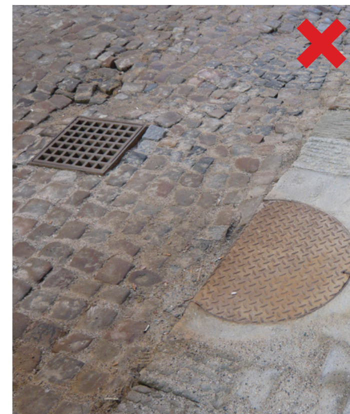
Obr. 5 Nejednotné řešení uličních vpustí Odvodnění řešit středovým žlabem a vpustí ve středu vozovky
