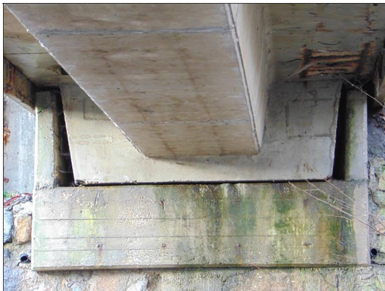
pravobřežní OP1 - zatékání na opěru a vypadané
