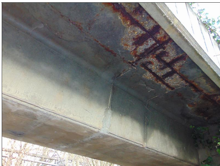
typický detail v podhledu na výtoku - zatékání, průsaky, obnažená korodující oslabená výztuž
