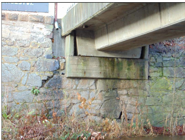
pravobřežní OP1 - zatékání na opěru a vypadané
