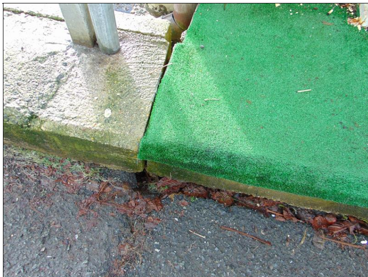
předpolí a přechodová oblast nad pravobřežní OP1 - oblast výrazného zatékání na OP1
