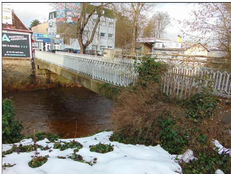
celkový pohled zprava - výtok
