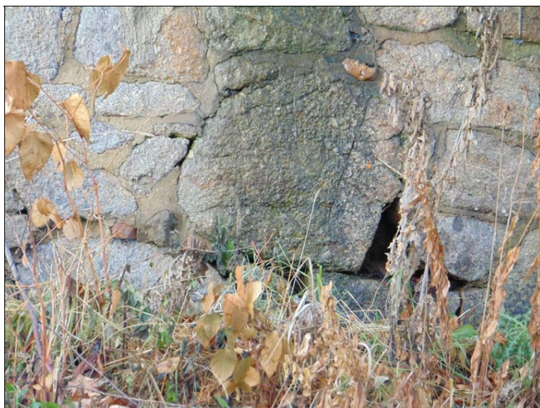
pravobřežní OP1 - vyplavené spárování v úrovni kolísavé hladiny
