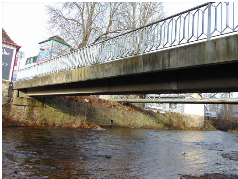
boční pohled NK zprava - výtok
