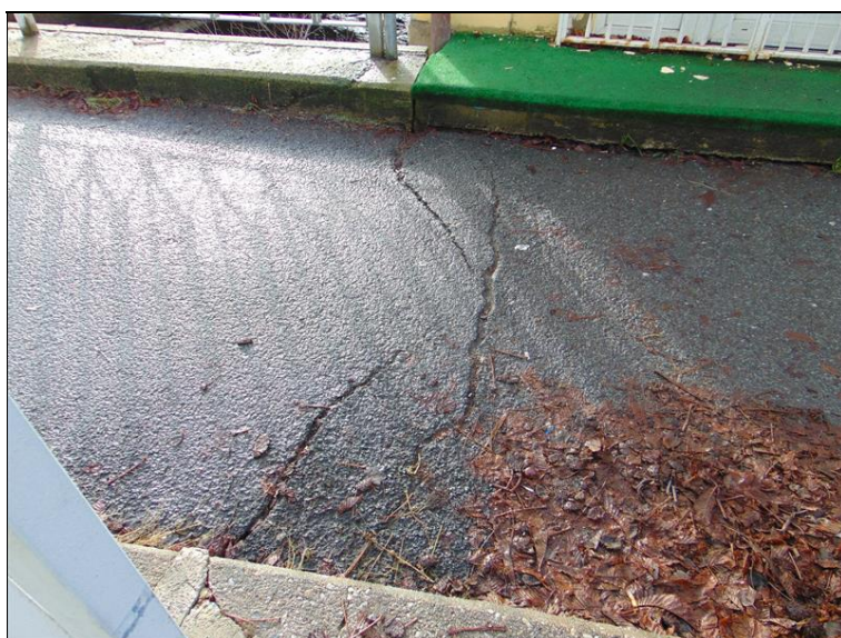
předpolí a přechodová oblast nad pravobřežní OP1 - oblast výrazného zatékání na OP1
