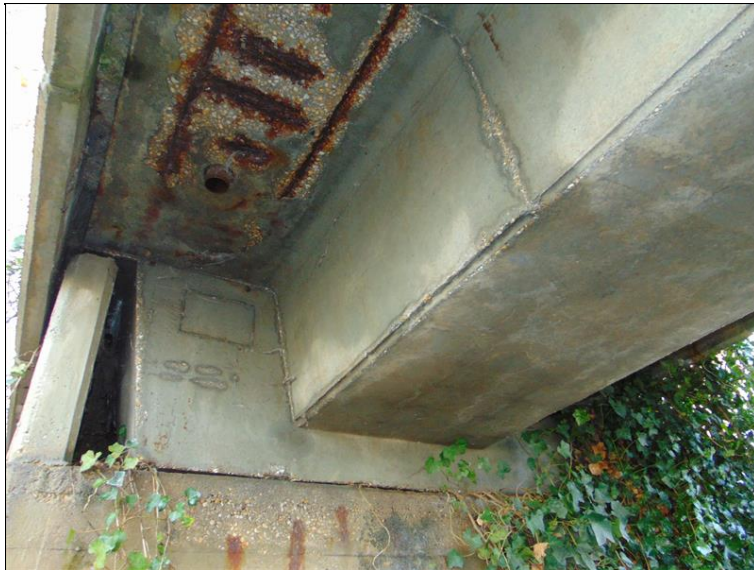
typický detail v pohledu na vtok - zatékání, průsaky, obnažená korodující oslabená výztuž
