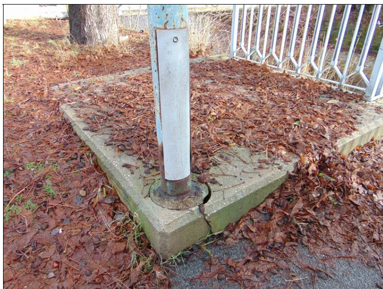
sloup VO vlevo na začátku, odtržená římsa
