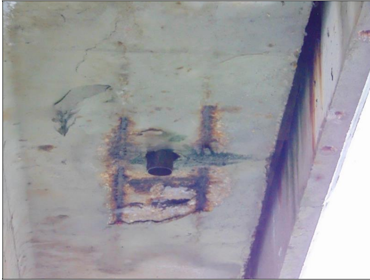
typický detail v pohledu na vtok - zatékání, průsaky, obnažená korodující oslabená výztuž
