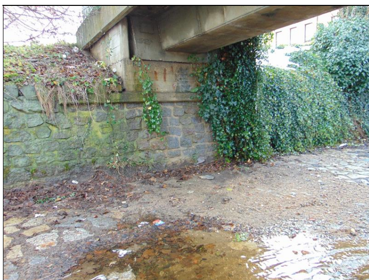
levobřežní OP2 - zatékání na opěru, hustá popínavá vegetace
