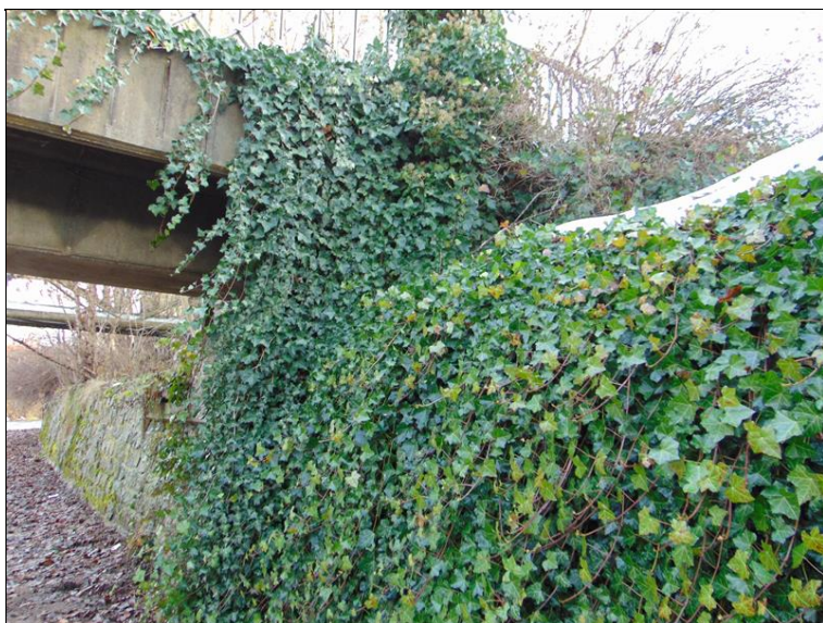
levobřežní OP2 - zatékání na opěru, hustá popínavá vegetace na výtokové straně
