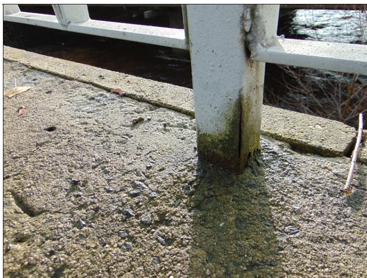
lokálně prasklé sloupky zábradlí, koroze, zašlý nátěr PKO
