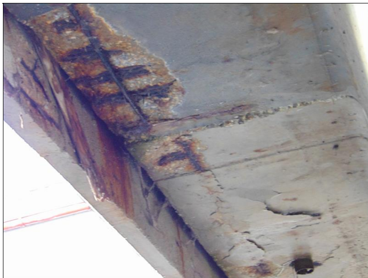
typický detail v podhledu na výtoku - zatékání, průsaky, obnažená korodující oslabená výztuž
