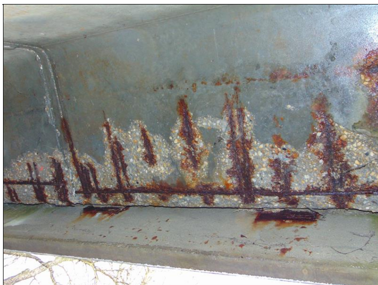
typický detail v pohledu na vtok - zatékání, průsaky, obnažená korodující oslabená výztuž
