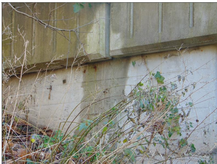
levobřežní OP2 - vtok, zatékání dilatační spárou
