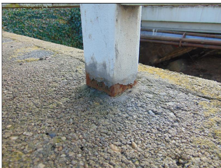
typický detail sloupků zábradlí, koroze u říms, zašlý nátěr PKO
