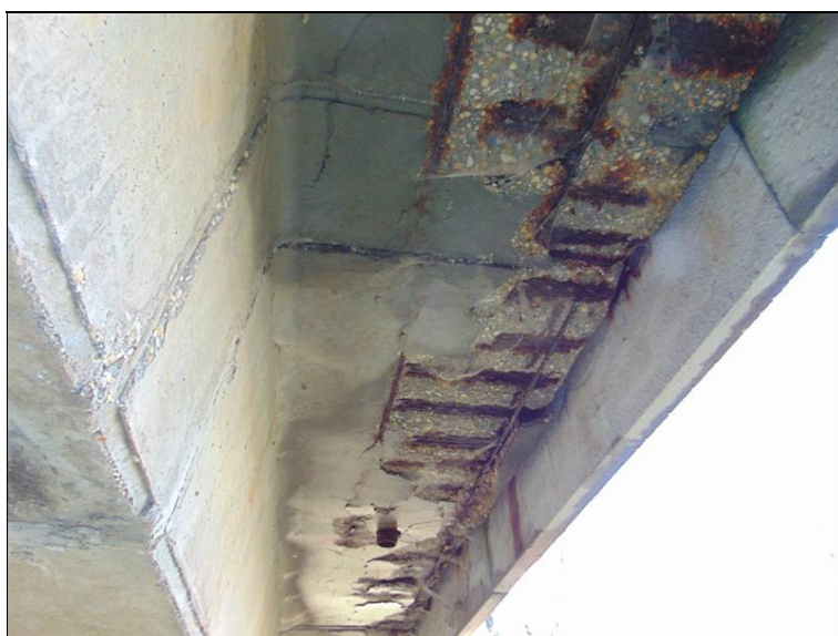
typický detail v podhledu na vtoku - zatékání, průsaky, obnažená korodující oslabená výztuž
