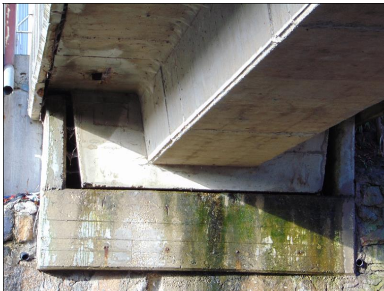
pravobřežní OP1 - zatékání na opěru
