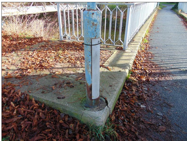
provizorně nedostatečně zabezpečená elektroinstalace sloupu VO vlevo na začátku, odtržená římsa
