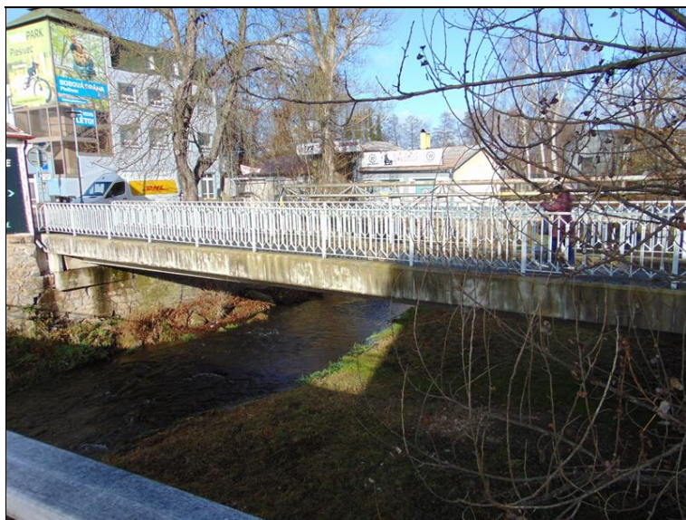
celkový pohled zprava - výtok
