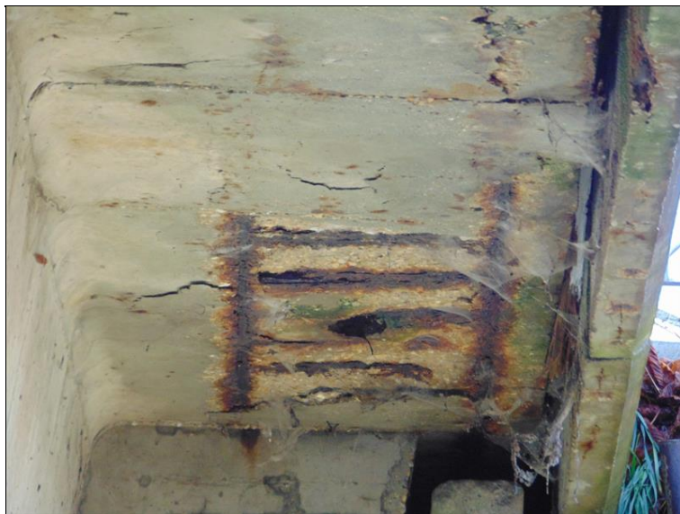
typický detail v podhledu na vtoku nad OP1 - zatékání, průsaky, obnažená korodující oslabená výztuž, odrezlý svod odvodnění
