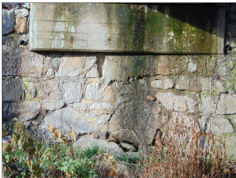
pravobřežní OP1 - zatékání na opěru a vypadané (vyplavené) spárování
