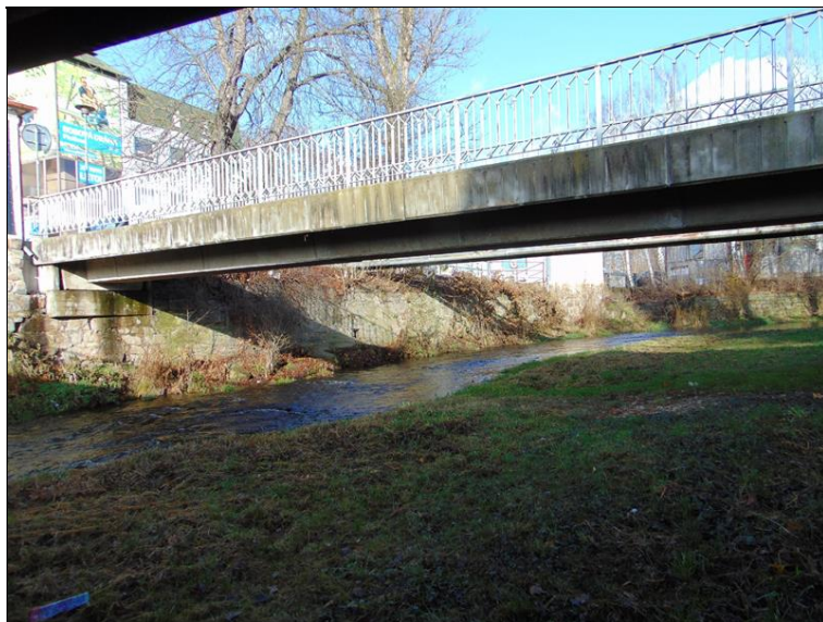
boční pohled NK zprava (výtok)
