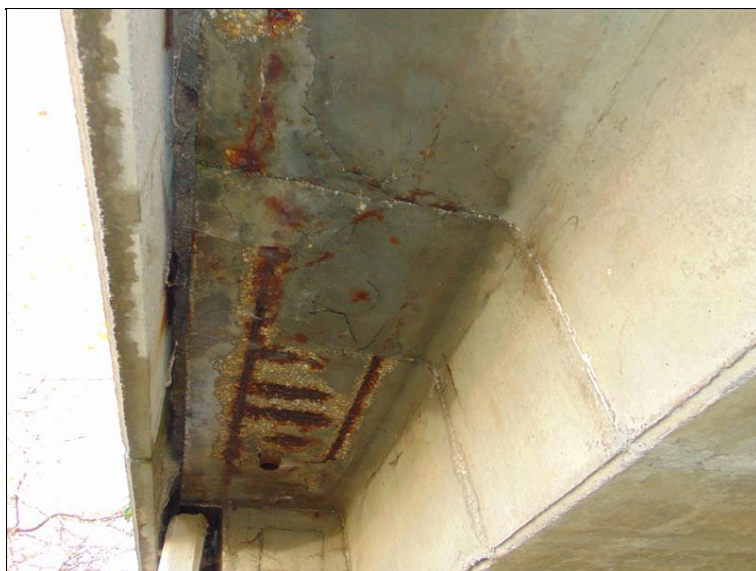
typický detail v podhledu na vtoku nad OP2 - zatékání, průsaky, obnažená korodující oslabená výztuž
