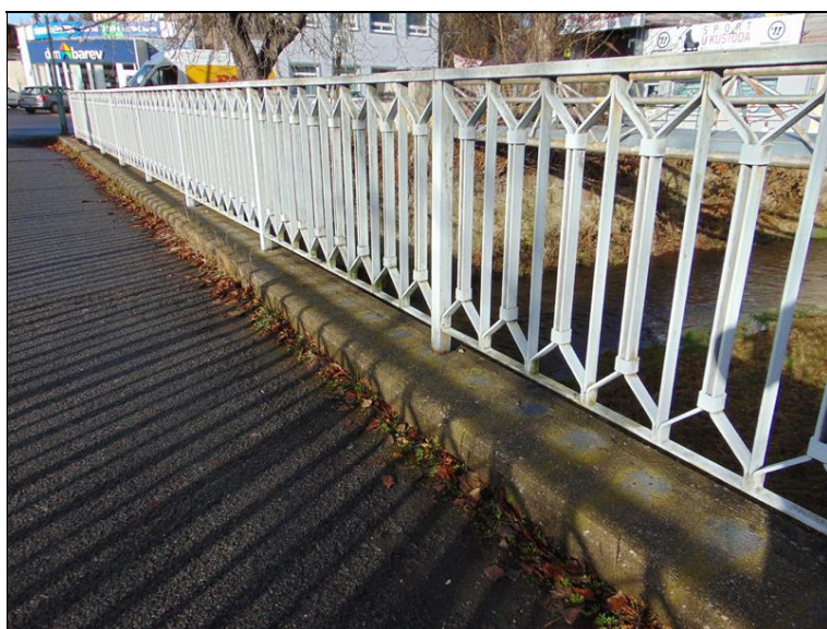
zábradlí a římsa na vtoku, vegetace u říms v komunikaci
