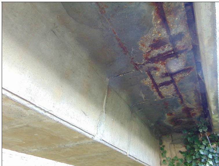
typický detail v podhledu na výtoku nad OP2 - zatékání, průsaky, obnažená korodující oslabená výztuž
