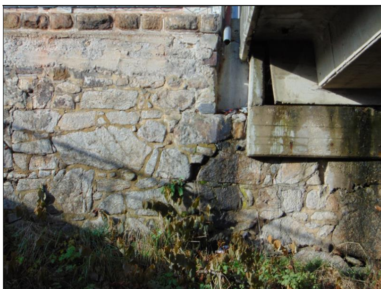
pravobřežní OP1 - zatékání na opěru na výtoku z pravobřežního předpolí komunikace a z okapového svodu přilehlé budovy
