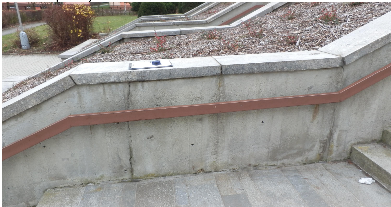
Dvě dilatační praskliny
