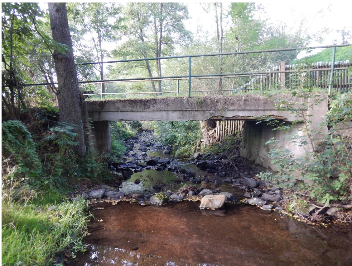
Obrázek 7 Nekapacitní most PF_19_M (ř. km 0,932) v havarijním stavu
