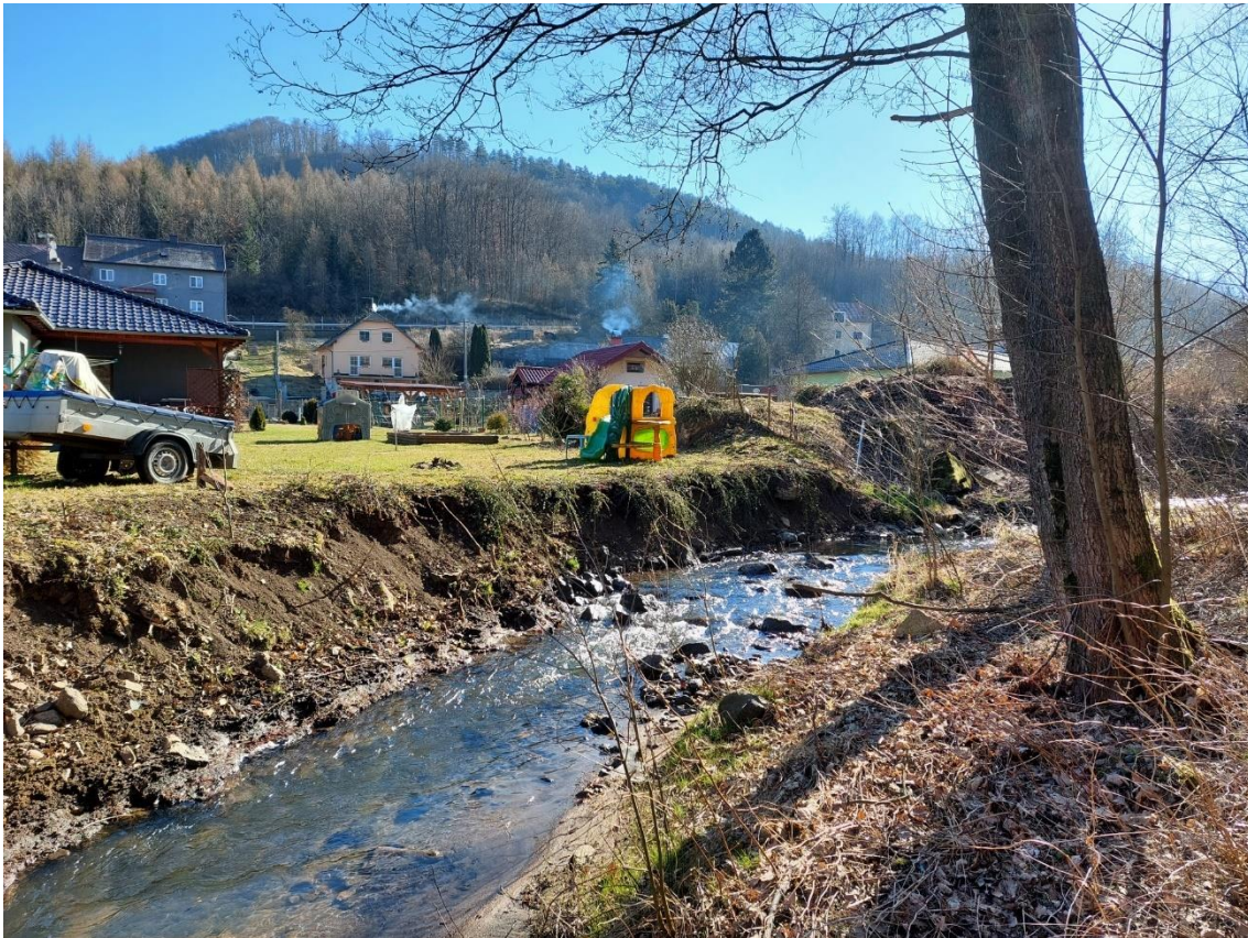
Obrázek 6 Přerušená hrázka na pravém břehu (ř. km 0,720)
