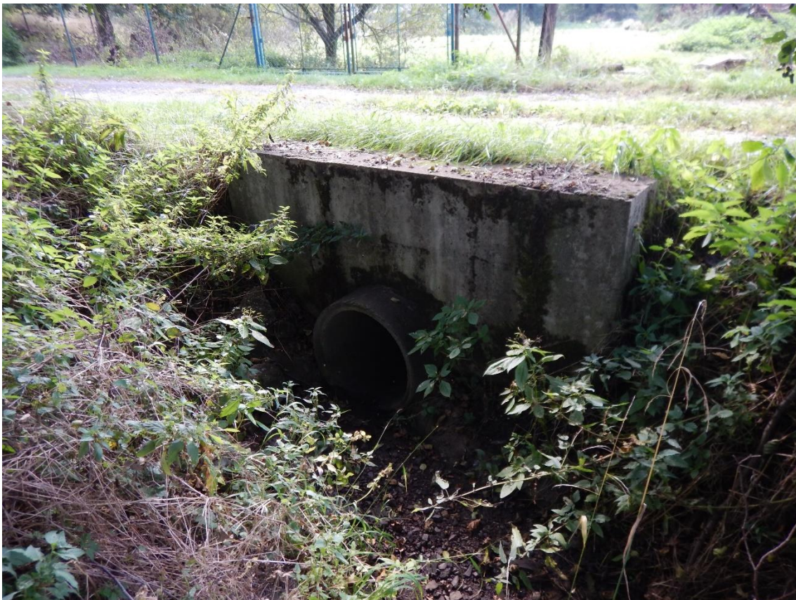
Obrázek 7 Nekapacitní propustek PF_15_P (ř. km 2,626)
