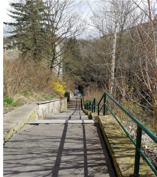
Asfaltový povrch podest schodiště je již nevyhovující.
