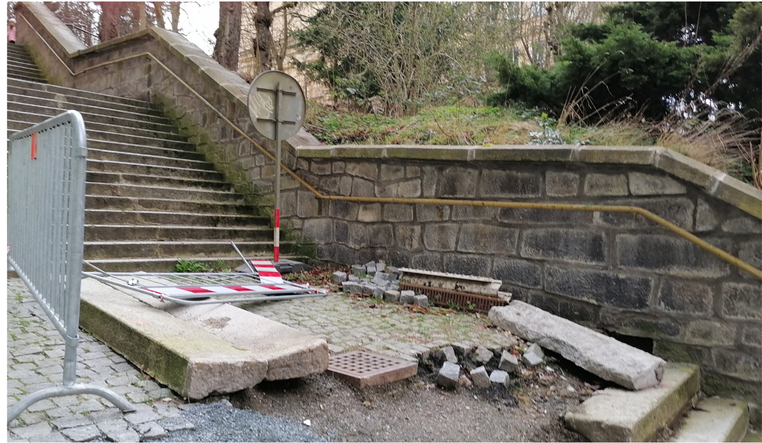
Betonové schodiště je v havarijním stavu a vyžaduje celkovou rekonstrukci, s případným doplněním středového zábradlí.
